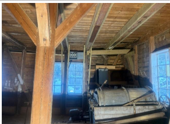
Bilde nr. 2.47 Fuktskader innvendig side av kledning 5. etasje
