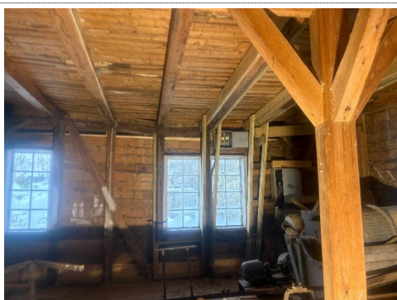
Bilde nr. 2.11 Råteskade på bjelke og stender. Det er gjennomført forsterking på bjelke og stender.
