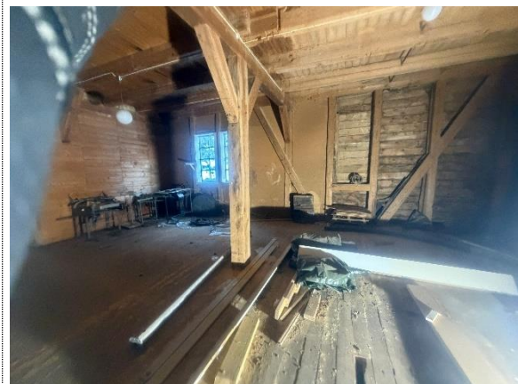
Bilde nr. 2.56 Nedbrutt gulv og hull, 4. etasje
