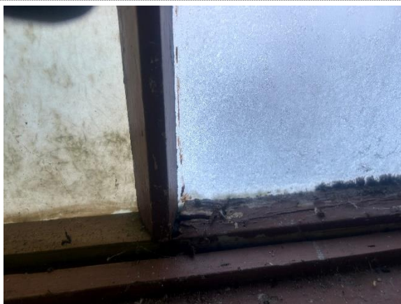
Bilde nr. 2.23 Råte i bunnramme av vindu 4. etasje
