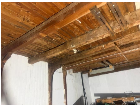
Bilde nr. 2.55 Fuktskadet himling og veggoverflate i 3. etasje
