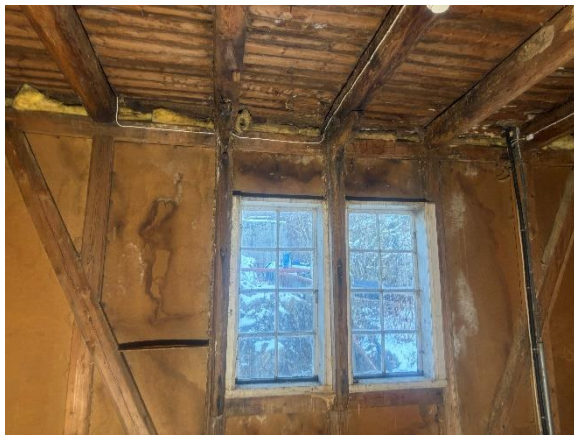
Bilde nr. 2.19 Mye råteskade på stendere og bjelkelag i 4. etasje
