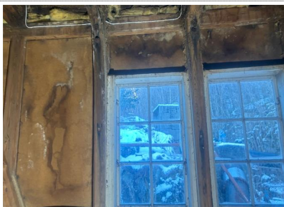
Bilde nr. 2.45 Fuktskader veggplate 4. etasje
