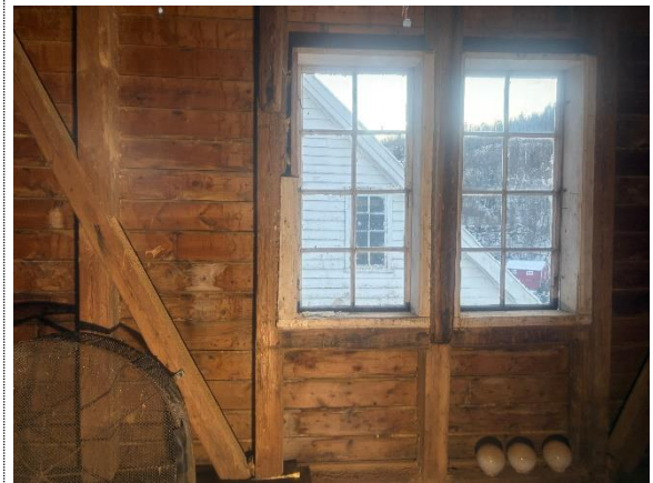
Bilde nr. 2.20 Råteskader på innvendig side av kledning
