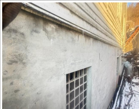
Bilde nr. 2.40 Risskader ovenfor vinduet
