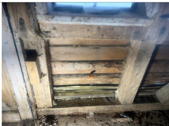
Bilde nr. 2.09 Stender ved inngang til kjeller, tørrsprekker og nedbrytning av skadedyr antagelig borehull fra borebiller.
