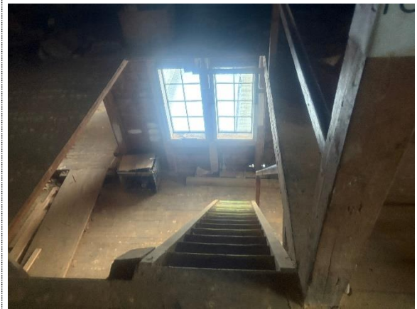
Bilde nr. 2.88 Trapp fra 5. etasje til 6. etasje, manglende rekkverk.
