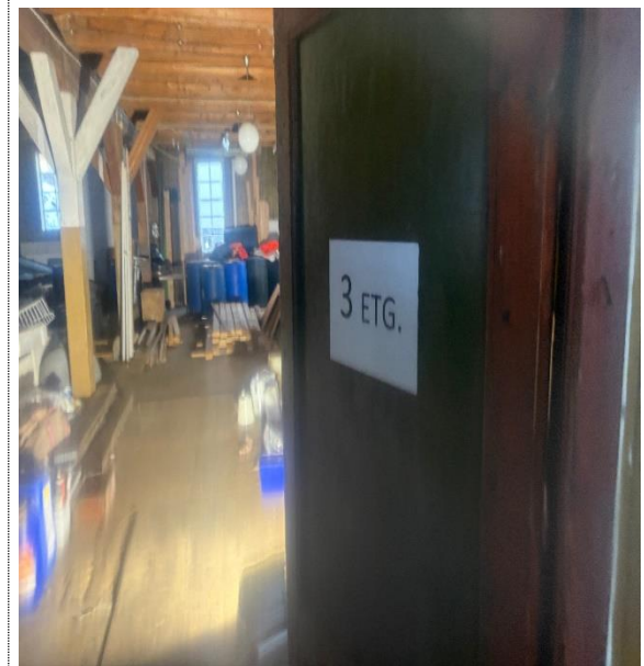
Bilde nr. 2.30 Eldre tredør i 3. etasje
