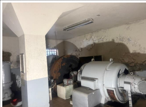
Bilde nr. 2.50 Avskalling av maling på innvendig side av teglvegg i kjeller.
