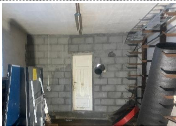
Bilde nr. 2.49 Lettklinkerblokker i kjeller med noe punktskade i kjelleren.
