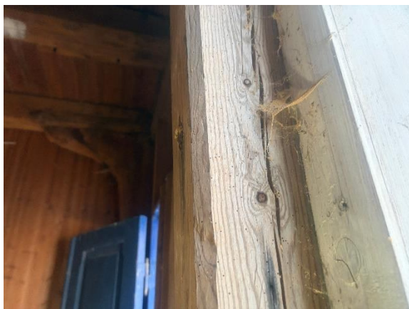
Bilde nr. 2.21 Skader fra borebiller
