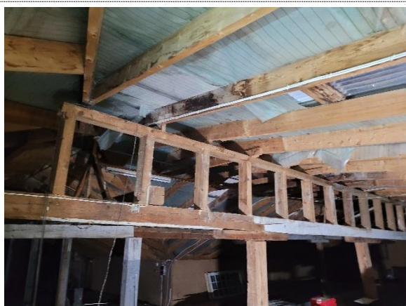
Bilde nr. 2.83 Saltak på sidebygg. Manglende takfolie
