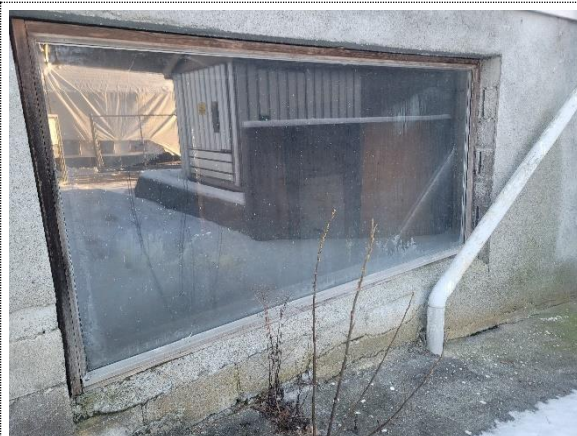
Bilde nr. 2.54 Manglende tildekking av smyg og spalte rundt vindu
