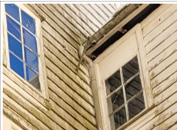
Bilde nr. 2.90 Løstnet taknedløp på gangbro mot byggmølle
