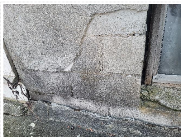
Bilde nr. 2.46 Avskalling i puss
