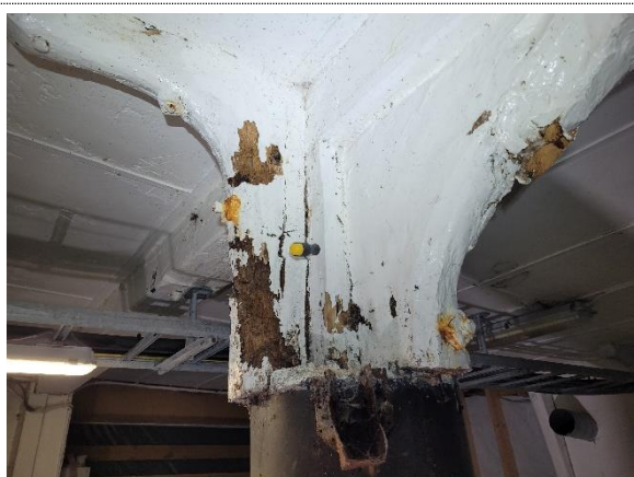
Bilde nr. 2.15 Stolpe og rotgrein med råteskade i plan 1
