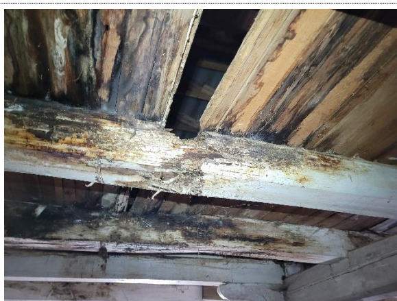
Bilde nr. 2.21 Råteskadet bjelke i plan 2
