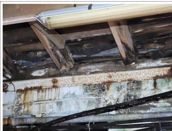
Bilde nr. 2.86 Store råteskader ved sperrefot mot sidebygg
