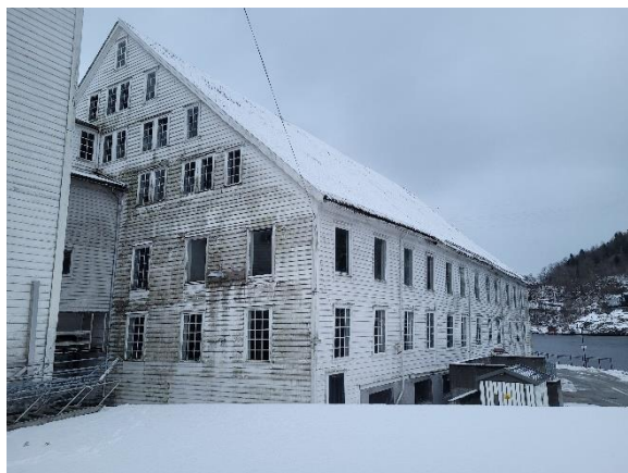
Bilde nr. 2.33 Synlige retningsavvik på fasaden og takforkant
