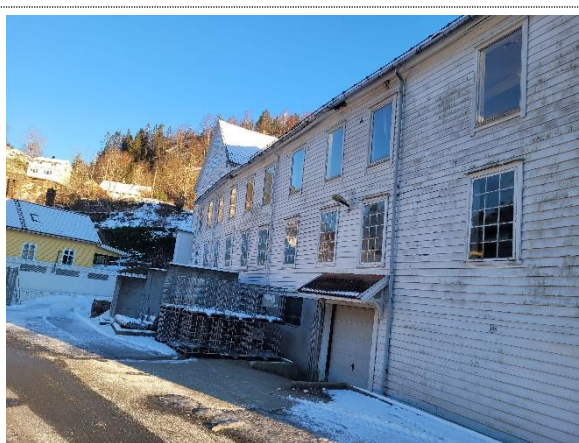
Bilde nr. 2.91 Tegn til nedbøyning av takrenner ved takforkant
