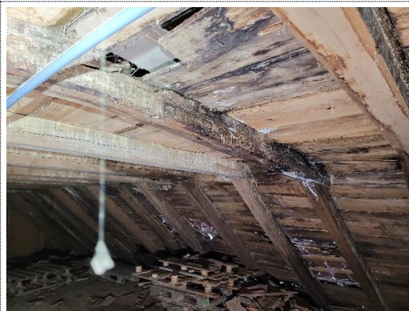
Bilde nr. 2.78 Råtne sperrer, bjelker og undertaksbord i plan 6
