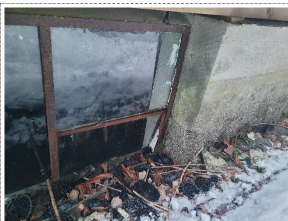
Bilde nr. 2.58 Jernvindu med korrosjonskader i karm
