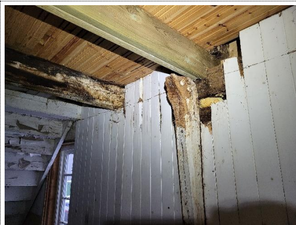
Bilde nr. 2.72 Bjelkelag i plan 2 med stedvis utskiftede bjelker pga råte
