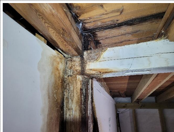
Bilde nr. 2.20 Bjelkeende med synlig oppfukning, soppangrep og råte i plan 2
