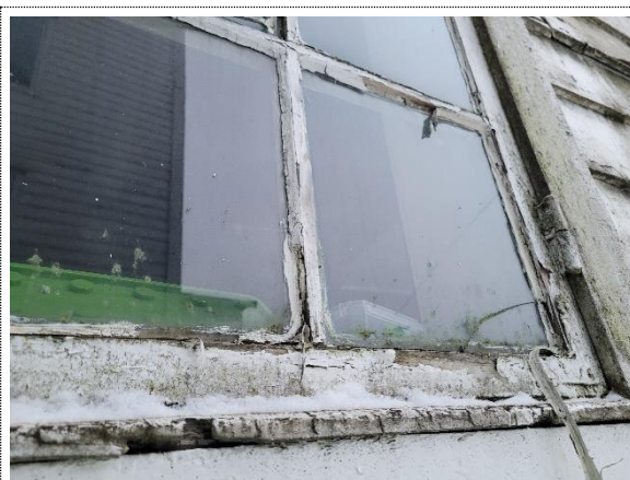
Bilde nr. 2.50 Smårutede trevinduer mot nord. Div. skader
