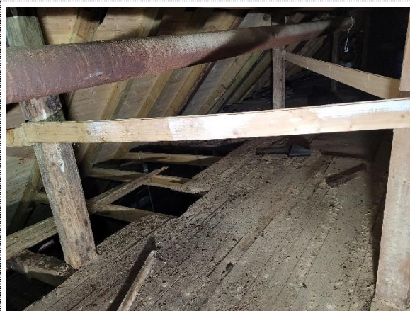
Bilde nr. 2.68 Manglende og råttent tregulv på loftsrom i plan 5
