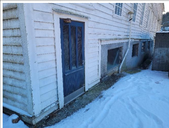
Bilde nr. 2.60 Ytterdør mot vest
