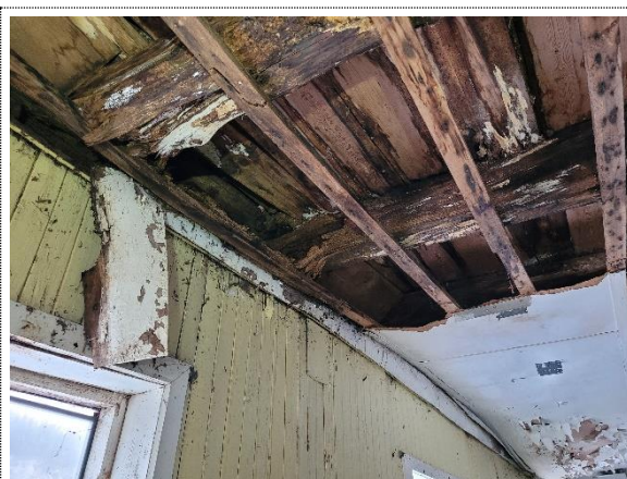
Bilde nr. 2.24 Kritisk råteskade på loftsbejelkeender i plan 3
