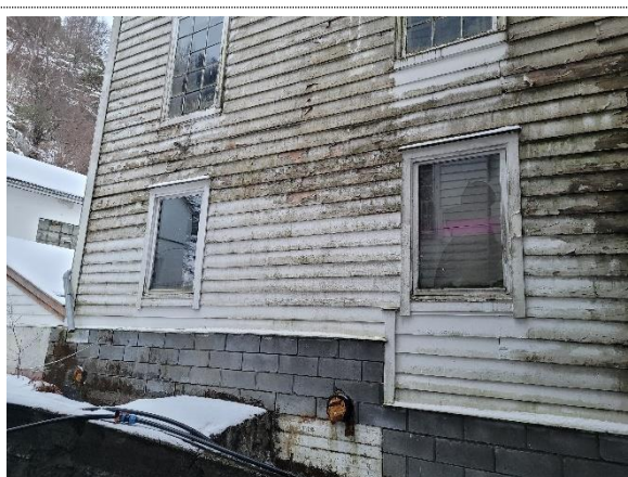
Bilde nr. 2.51 Ett fags vindu mot nord. Knust rute.
