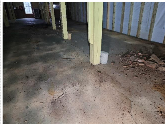
Bilde nr. 2.26 Sprekkdannelser i betongpåstøp plan 3 på øst side av hovedbygg
