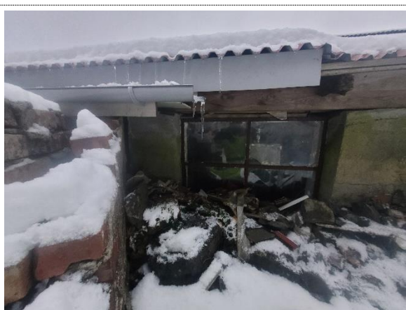
Bilde nr. 2.57 Jernvindu med fuktbelastning fra løsmasser og takavrenning
