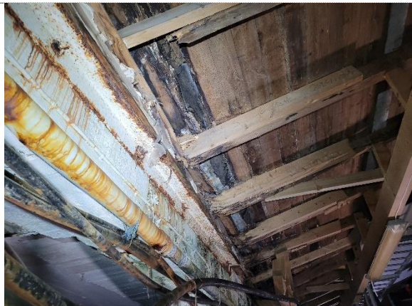
Bilde nr. 2.25 Stålvinkel for opplegg av tak med overflatekorrosjon
