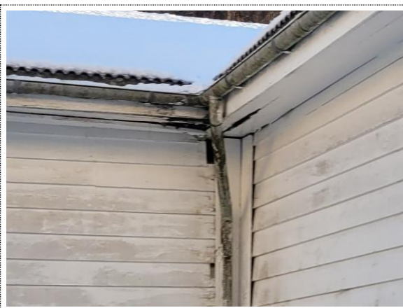
Bilde nr. 2.88 Råteskader i gesimskasse og skader på taknedløp
