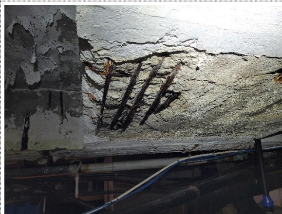
Bilde nr. 2.66 Armeringskorrosjon i betongbjelke i sidebygg
