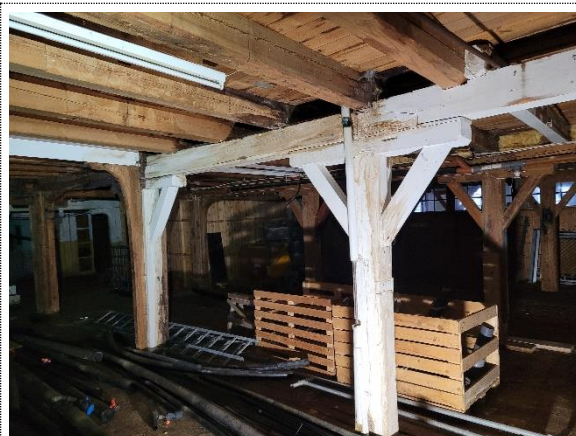
Bilde nr. 2.16 Stolpe med skråband med fuktmerker i plan 2
