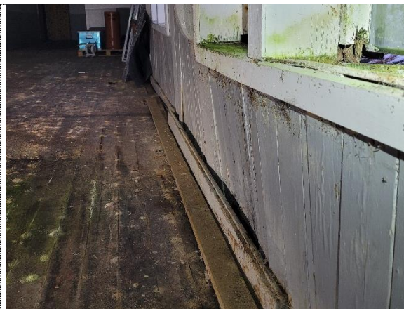
Bilde nr. 2.36 Vegg i sidebygg med fuktproblem og råte
