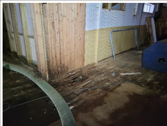
Bilde nr. 2.70 Tregulv med råteskade og hull i gulv i plan 2
