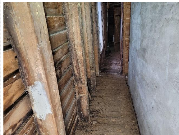
Bilde nr. 2.34 Råteskade i gavlvegg mot sør på plan 5
