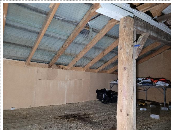
Bilde nr. 2.84 Tak i sidebygg med lekkasje ved strekkstag gjennom tak
