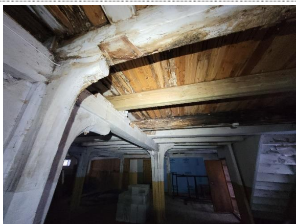
Bilde nr. 2.71 Bjelkelag i plan 2 med fuktmerker og råte
