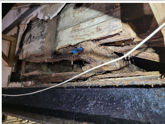
Bilde nr. 2.19 Råteskader på bjelkeende og i overliggende yttervegg for mellombygg i plan 1
