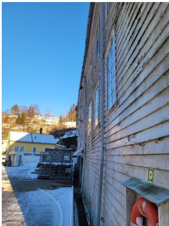
Bilde nr. 2.31 Synlige retningsavvik på fasaden og takforkant
