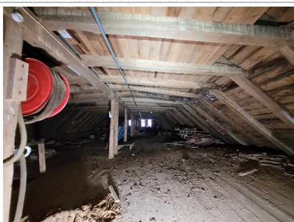
Bilde nr. 2.27 Sprekkdannelser i loftsbjelker på plan 6 på øst side av hovedbygg
