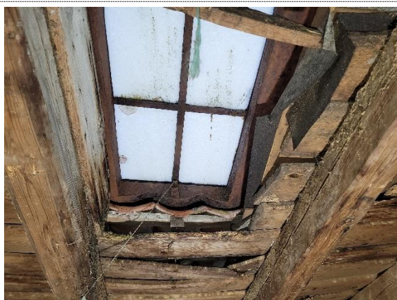
Bilde nr. 2.59 Loftsvindu med korrosjonskader og fuktskader i trevirket rundt vinduet
