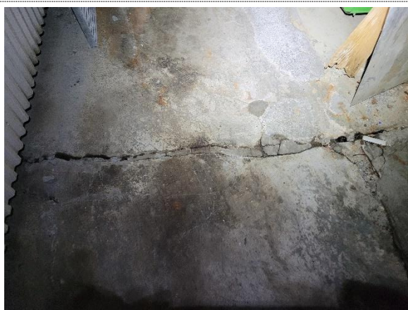
Bilde nr. 2.65 Sprekk i gulvstøp på plan 1
