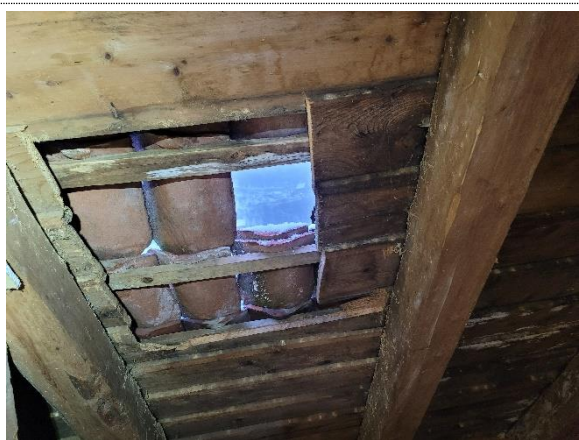
Bilde nr. 2.81 Undertak og løs takstein
