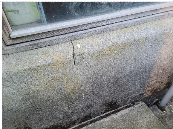
Bilde nr. 2.47 Riss i puss
