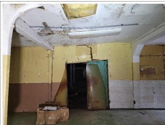
Bilde nr. 2.64 Innervegg med fuktskader i plan 3
