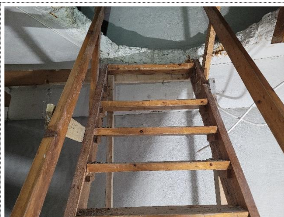
Bilde nr. 2.94 Trapp i sidebygg med manglende trinn
