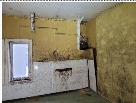
Bilde nr. 2.48 Innvendig overflate på yttervegg i plan 3 med fuktmerker og begroing
