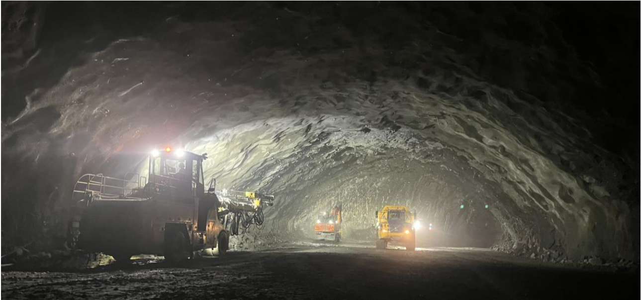
Figur 5 Detalj bilde av takskive før uttak av bunnstross i fjellhaller ved Kongshaugstranda RA (Foto Multiconsult)
